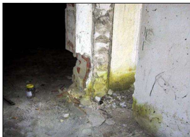
Obr. 1 Kontaminace \text{Cr}^{6+} patrná na zdech a podlaze chromovny
