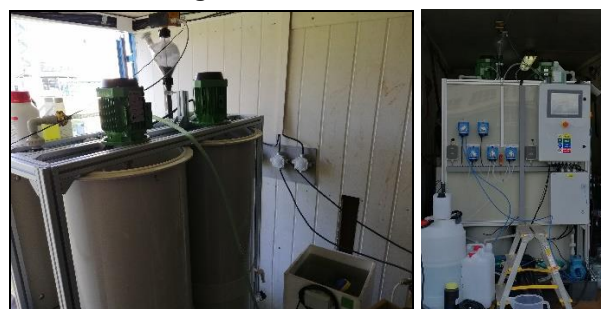
Obr. 3 Zadní část reaktoru s reakční a neutralizační nádobou (vlevo) a přední část reaktoru s dávkovacími čerpadly a ovládacím panelem (vpravo)
